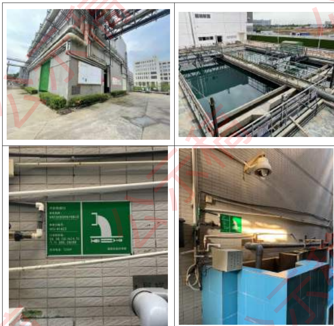
图 4.1-2 全厂废水处理站部分处理设施照片
