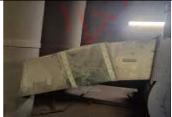
FQ-41423Z (现场空间受限无法设置规范的采样口)
